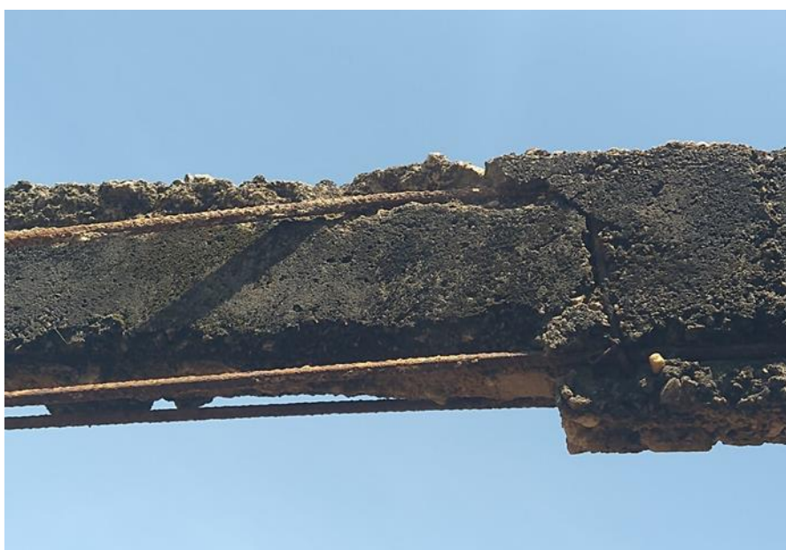
Figura 6 - Corrosão na estrutura de concreto armado
