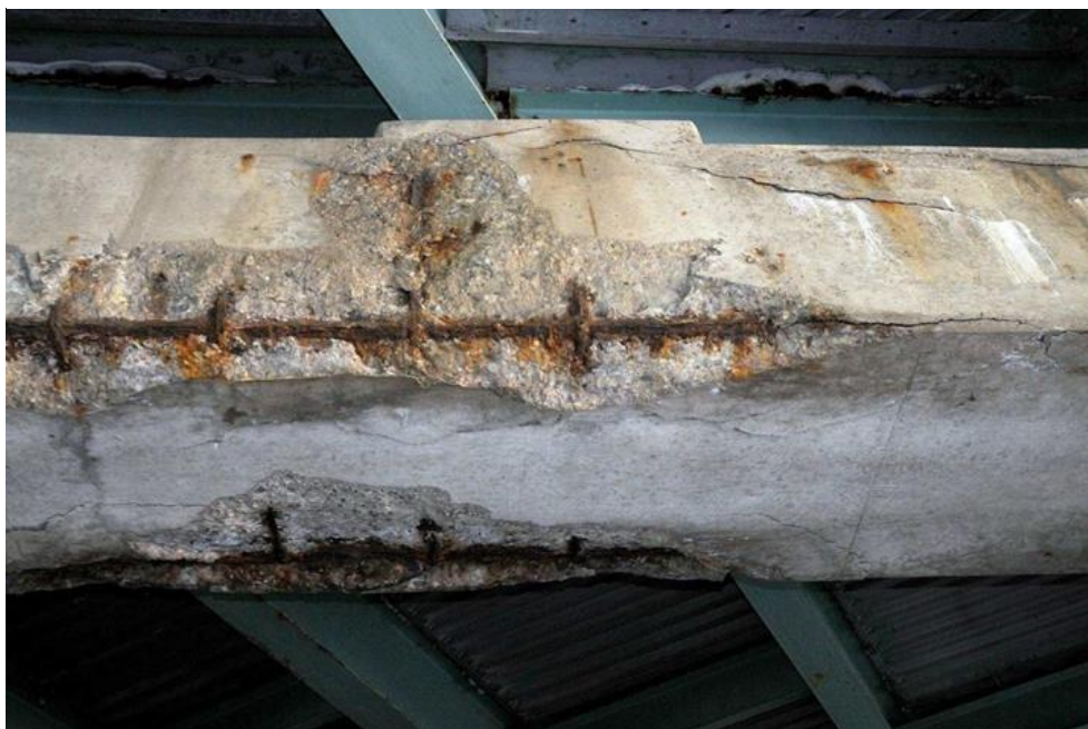
Figura 13 - Carbonatação na estrutura de concreto armado
