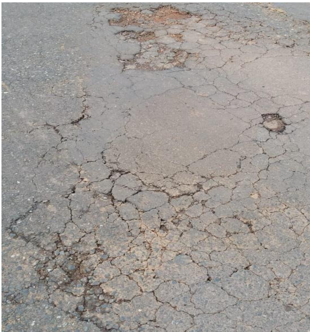
Figura 10 - Patologia tipo couro de jacaré B1 – Rodovia RO-140
