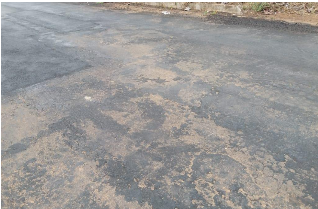
Figura 17 - Patologia tipo remendo D3 – Rodovia RO - 140
