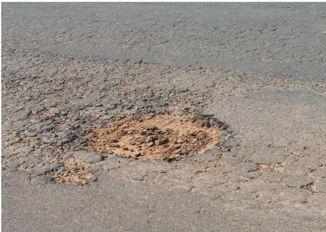
Figura 9 - Patologia tipo panela ou buraco A3 – Rodovia RO-140
