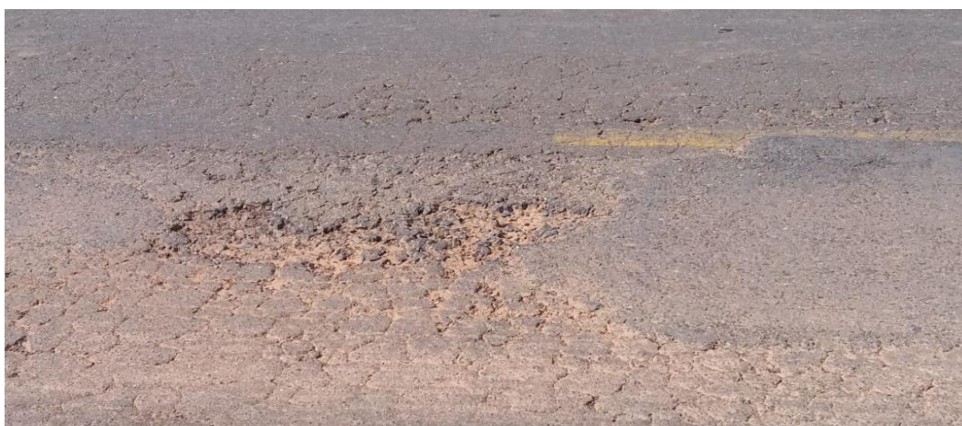
Figura 13 - Patologia tipo desgaste C1 – Rodovia – RO140
