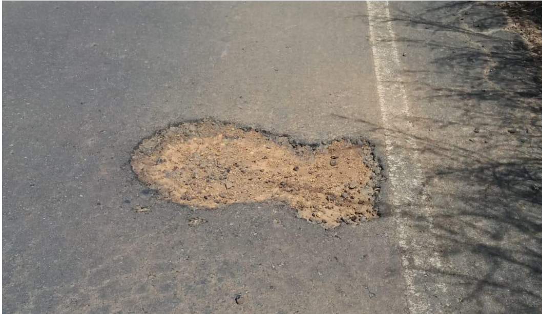
Figura 8 - Patologia tipo panela ou buraco A2 – Rodovia RO-140
