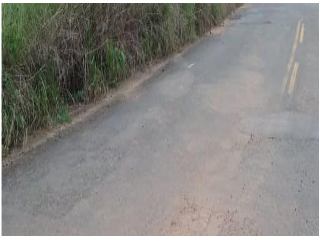
Figura 15 - Patologia tipo remendo D1 – Rodovia RO - 140
