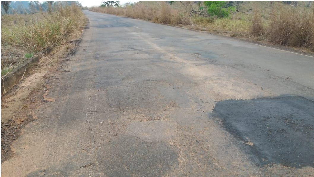
Figura 16 - Patologia tipo remendo D2 – Rodovia RO - 140
