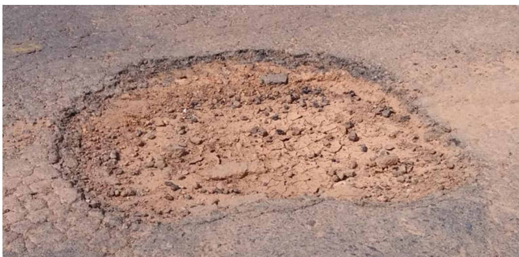
Figura 7 – Patologia tipo panela ou buraco A1 – Rodovia RO-140
