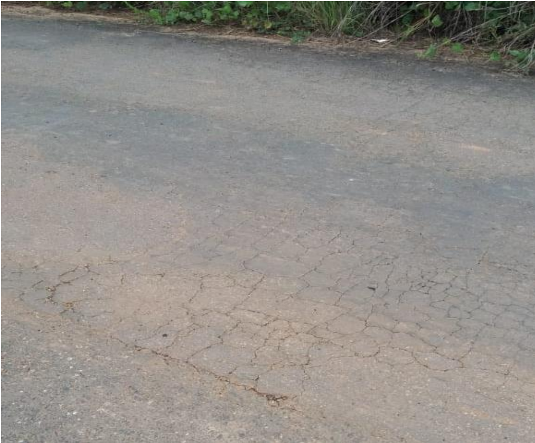
Figura 11 - Patologia tipo couro de jacaré B2 – Rodovia RO -140
