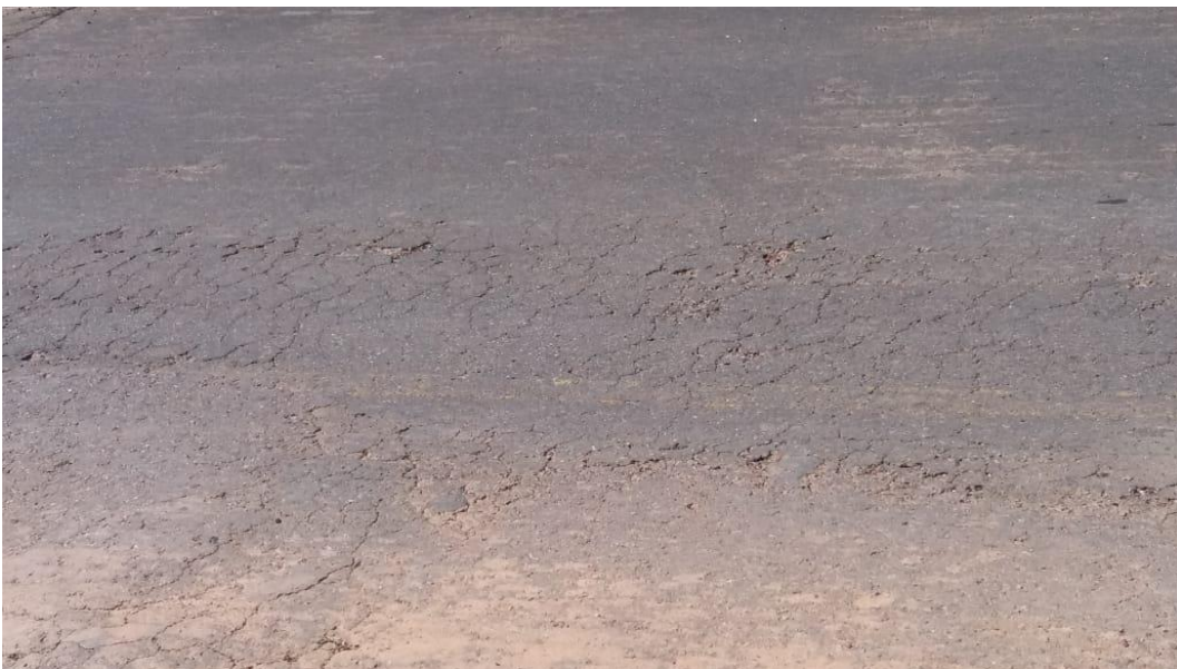
Figura 12 - Patologia tipo couro de jacaré B3 – Rodovia RO -140
