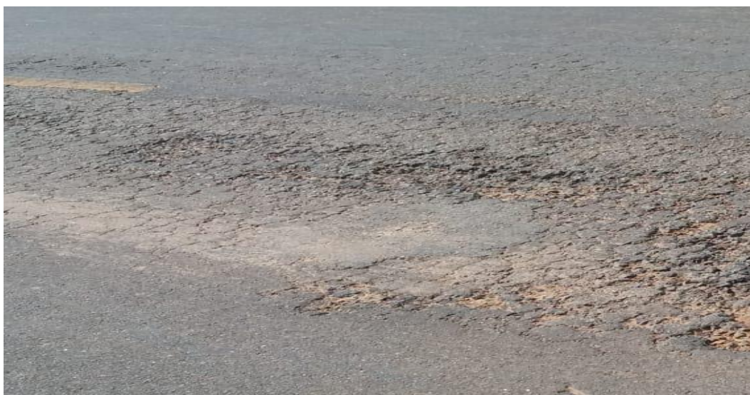
Figura 14 - Patologia tipo desgaste C2 – Rodovia RO -140
