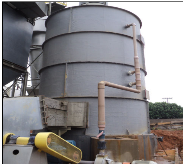
Figura 2 – Sistema de lavagem de gases Fonte: Arquivo pessoal do autor
