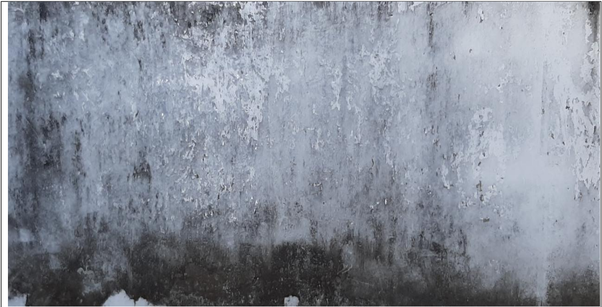
Figura 16 Parede com umidade e infiltração Fonte: Próprio Autor (2020)
