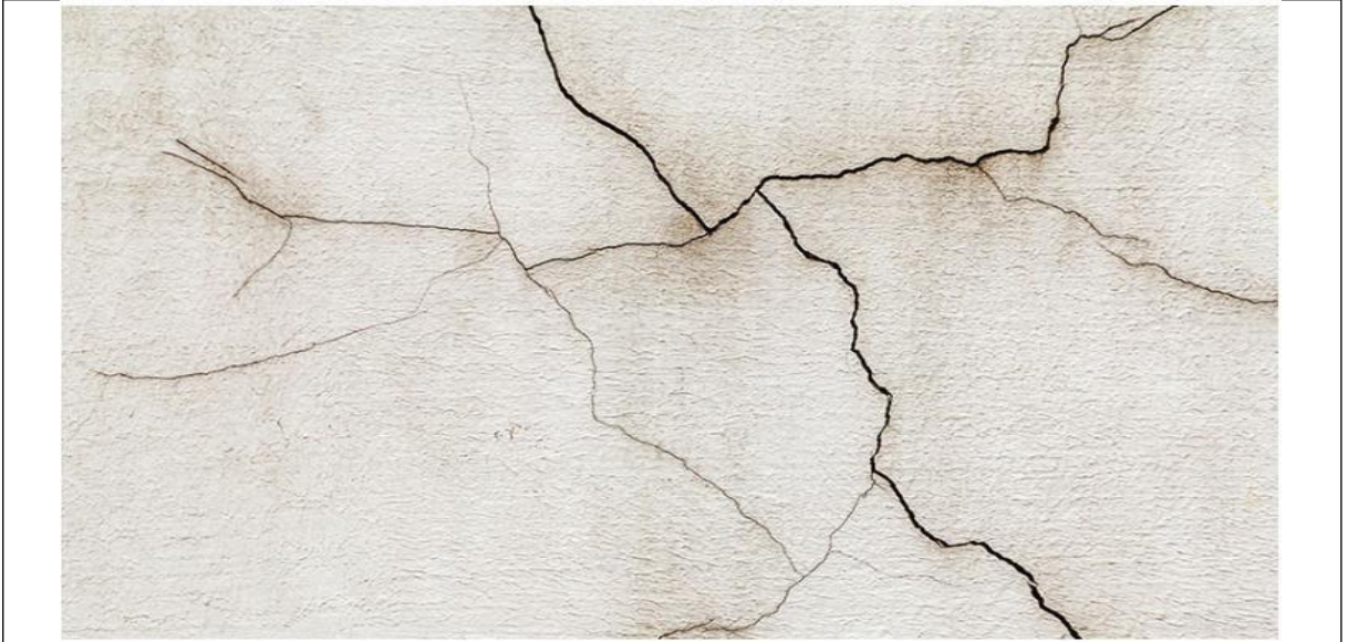
Figura 12 Fissuração nas paredes na construção convencional de alvenaria Fonte: Votorantim cimentos (2019)
