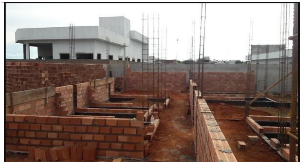
Figura 5 Execução da alvenaria, também pode ser chamada de superestrutura Fonte: Execução de alvenaria 2019
