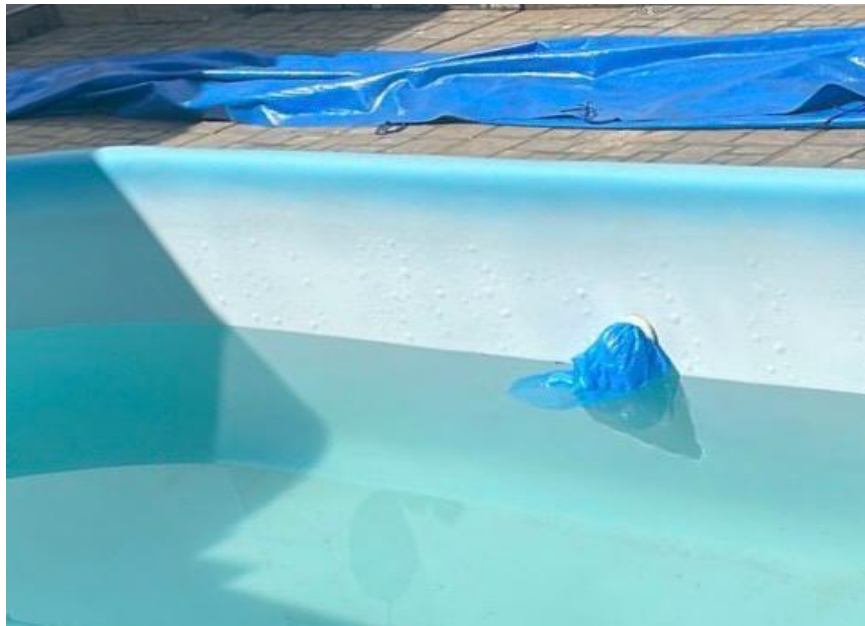
Figura 5 - Bolhas na parede de piscinas
