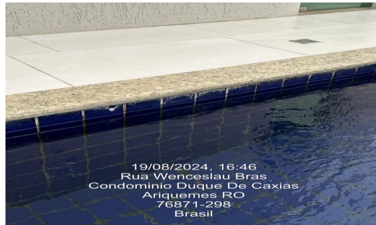
Figura 20 - PISCINA 8 – Eflorescência em piscinas
