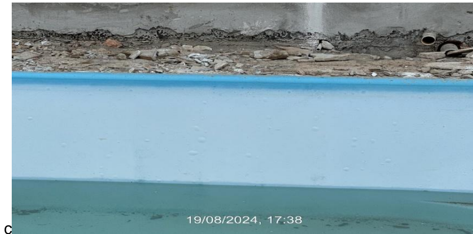
Figura 14 - PISCINA 2 – Bolhas na parede de piscinas
