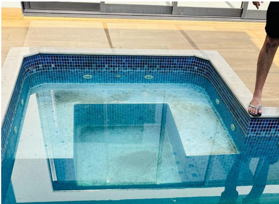
Figura 4 - Bolor em piscina
