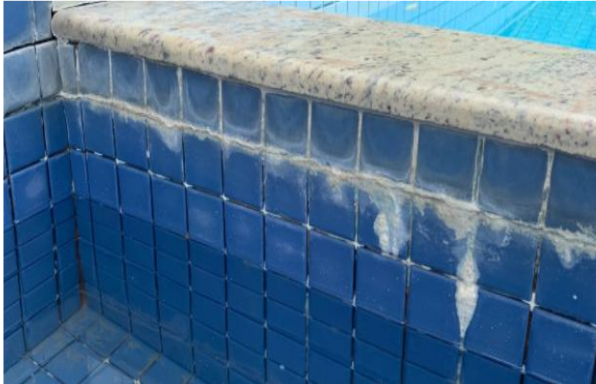
Figura 7 - Eflorescência em piscinas
