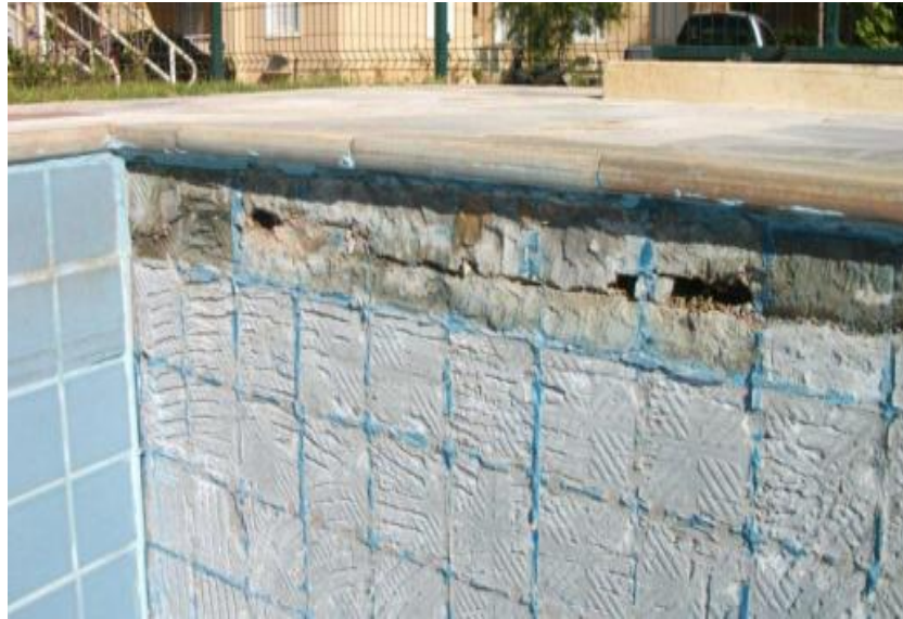
Figura 1- Fissura / rachadura em piscinas de concreto
