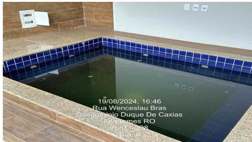
Figura 21 - PISCINA 9 – Eflorescência em piscinas
