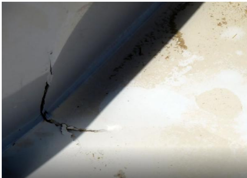
Figura 2 - Fissura / rachadura em piscinas de fibra de vidro
