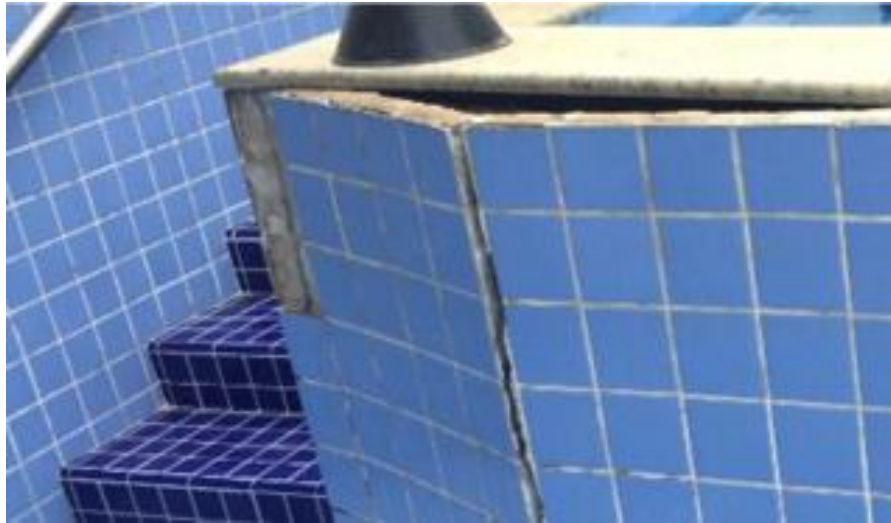
Figura 6 - Descolamento de azulejos em piscinas
