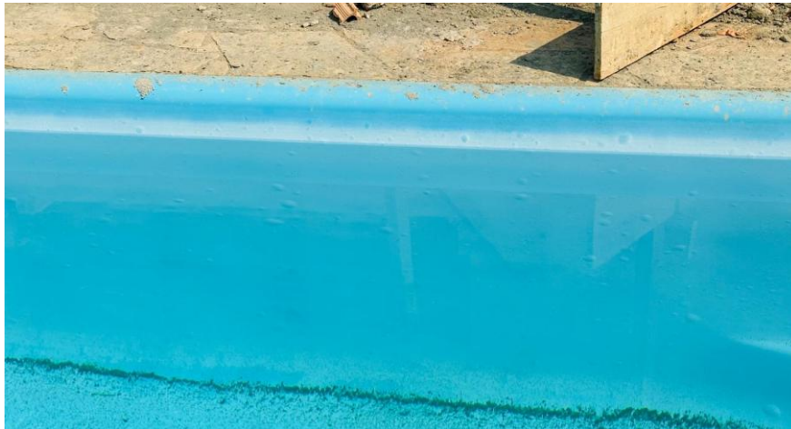
Figura 33 - PISCINA 21 – Bolhas na parede de piscina
