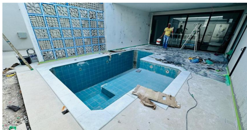
Figura 22 - PISCINA 10 – Eflorescência em Piscina
