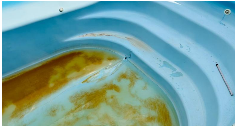
Figura 23 - PISCINA 11 – Fissura / rachadura em piscinas
