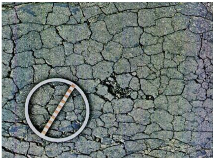
Figura 2 - Trinca interligada tipo Jacaré.
