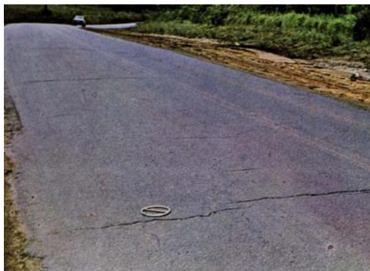
Figura 4 - Trinca isolada transversal.
