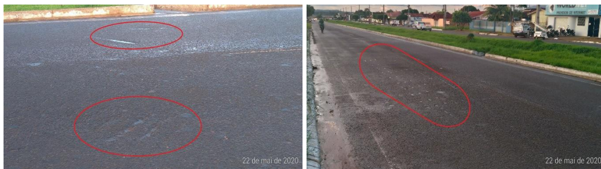
Figura 17 – Desgaste na camada de revestimento
