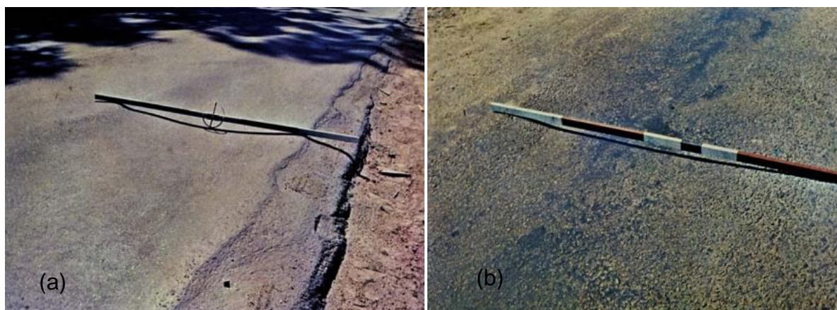
Figura 7 – Afundamento por trilha de roda (a) e afundamento local (b)
