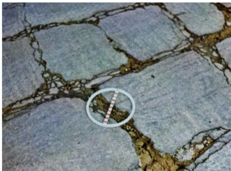
Figura 3 - Trinca interligada do tipo bloco.
