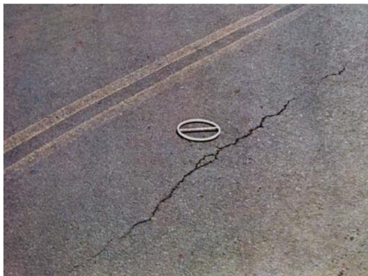
Figura 5 - Trinca isolada longitudinal.
