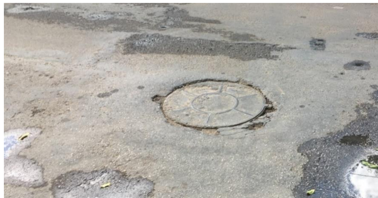
Figura 42 - Av. Tabapuã, trincas ao redor de PV
