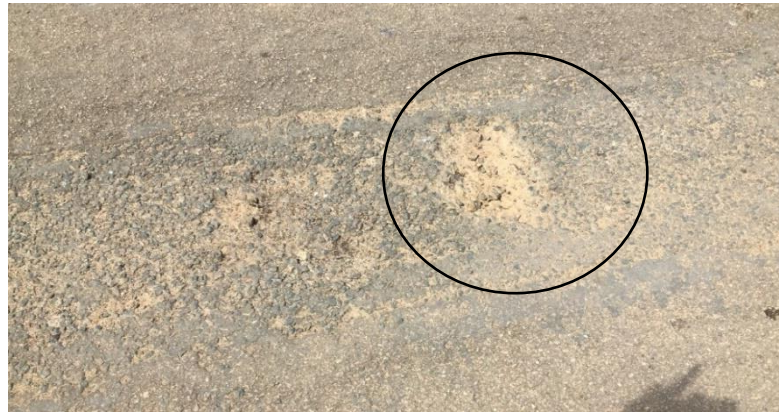
Figura 62 - Rua Florianópolis: patologia do tipo buraco
