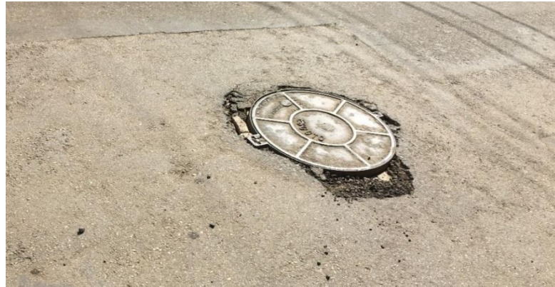
Figura 46 - Rua Curitiba, trincas e degradação do pavimento em torno do PV
