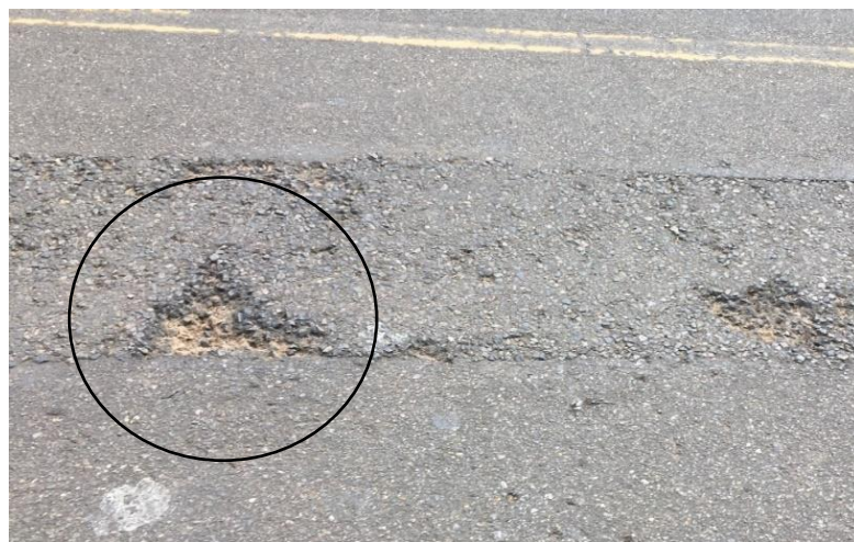
Figura 61 - Rua Curitiba: patologia do tipo buraco
