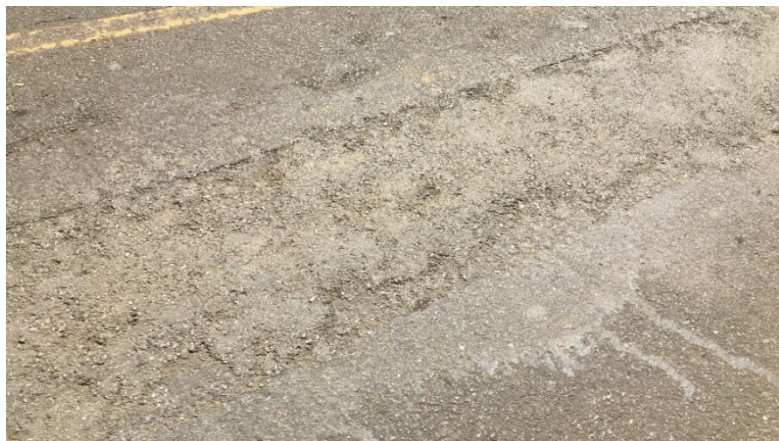
Figura 57 - Rua Curitiba: patologia do tipo desgaste
