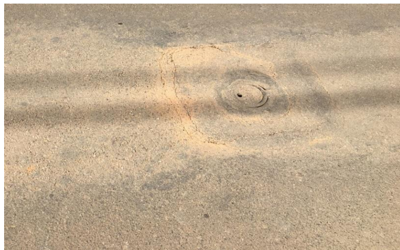
Figura 45 - Rua vitória, trincas ao redor de PI
