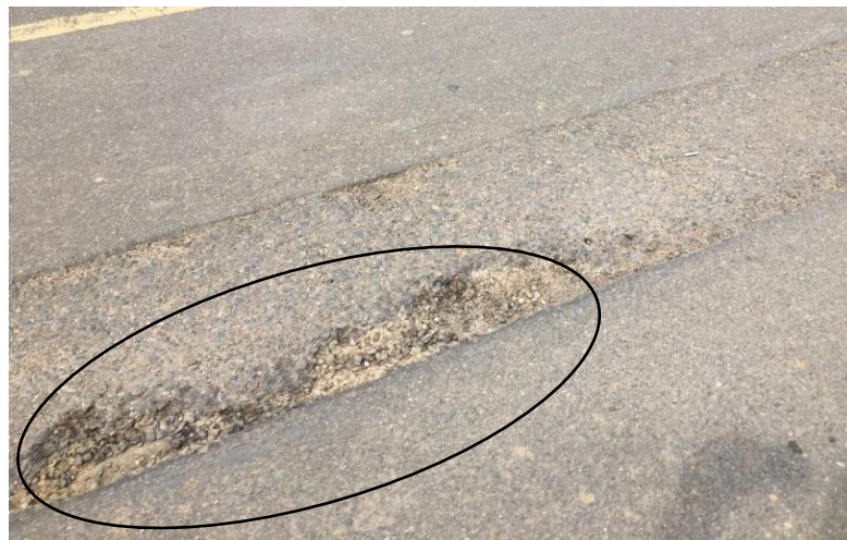
Figura 60 - Rua São Vicente: patologia do tipo buraco
