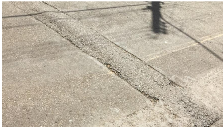
Figura 52 - Rua Curitiba: defeito do tipo ondulação
