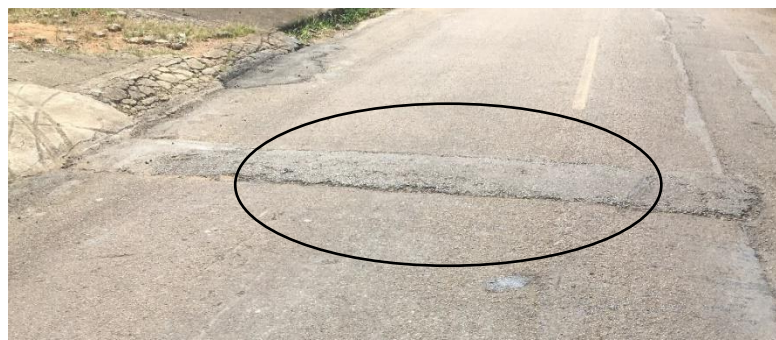
Figura 53 - Rua Porto Alegre: defeito do tipo ondulação
