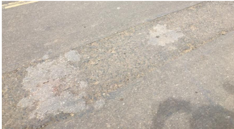
Figura 56 - Rua São Vicente: patologia do tipo desgaste
