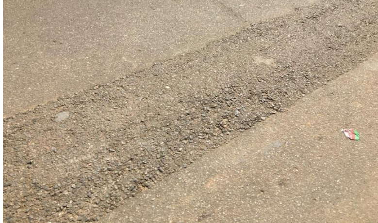
Figura 55 - Rua Rio de Janeiro: patologia do tipo desgaste
