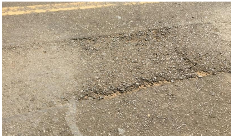
Figura 38 - Rua Curitiba, trinca entre pavimento novo e o antigo
