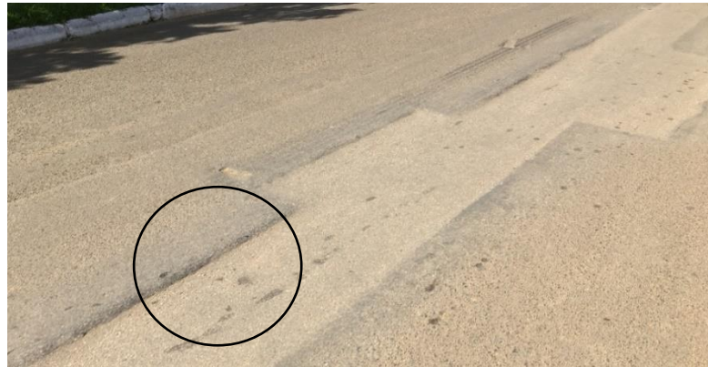
Figura 50 - Av. Tabapuã: afundamento de consolidação sobre a vala
