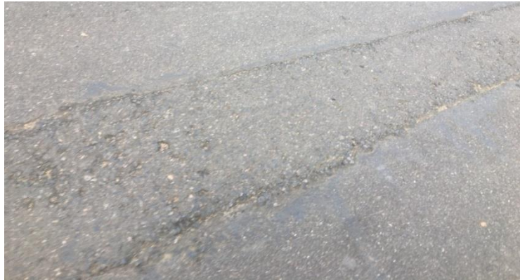
Figura 37 - Rua São Vicente, trinca entre pavimento novo e o antigo
