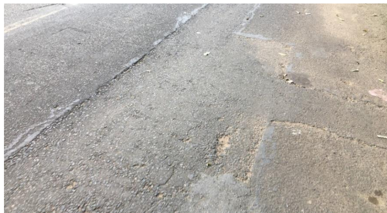
Figura 49 - Rua Curitiba: afundamento de consolidação sobre a vala
