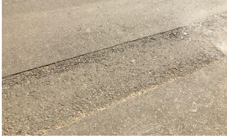
Figura 36 - Rua Rio de Janeiro, trinca entre pavimento novo e o antigo
