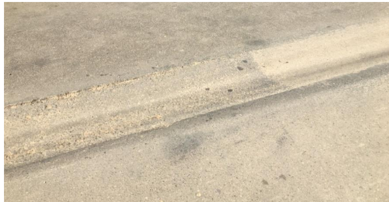
Figura 48 - Rua Vitória: afundamento de consolidação sobre a vala
