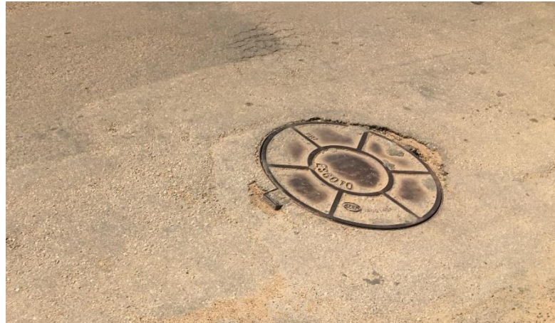
Figura 43 - Av. Tabapuã, trincas ao redor de PV
