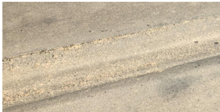
Figura 35 - Rua Vitória, trinca entre pavimento novo e o antigo
