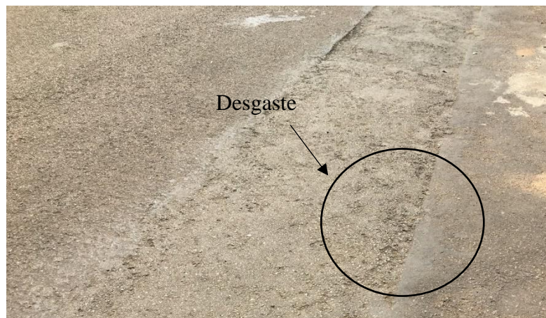
Figura 59 - Rua Porto Alegre: patologia do tipo desgaste
