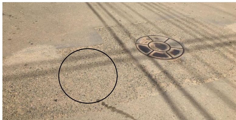
Figura 54 - Rua Vitória: patologia do tipo desgaste
