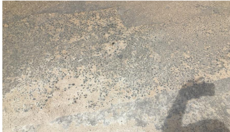
Figura 58 - Rua Florianópolis: patologia do tipo desgaste
