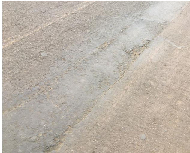
Figura 40 - Rua Porto Alegre, trinca entre pavimento novo e o antigo
