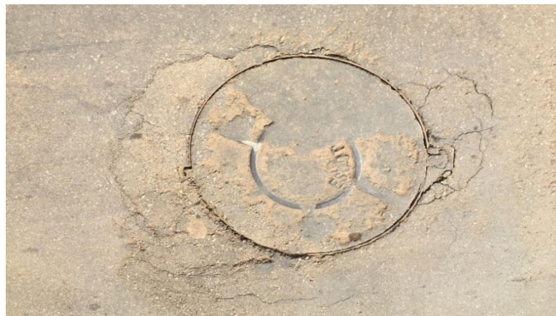
Figura 44 - Av. Tabapuã, trincas ao redor de PV
