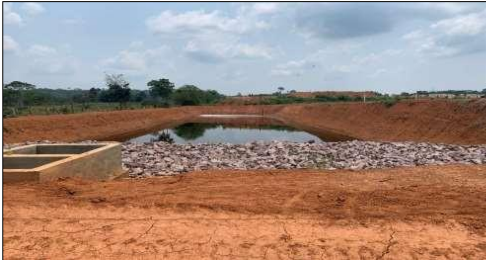
Figura 10 – Lagoa seca do sistema de lagoas do aterro sanitário
