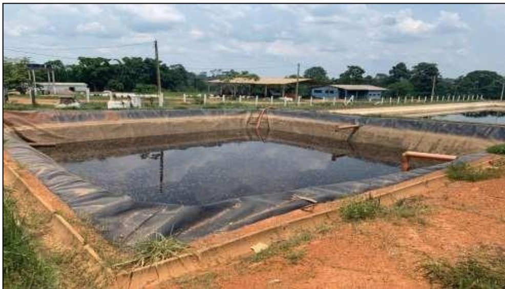
Figura 8 – Lagoa anaeróbia das células fechadas do aterro sanitário
