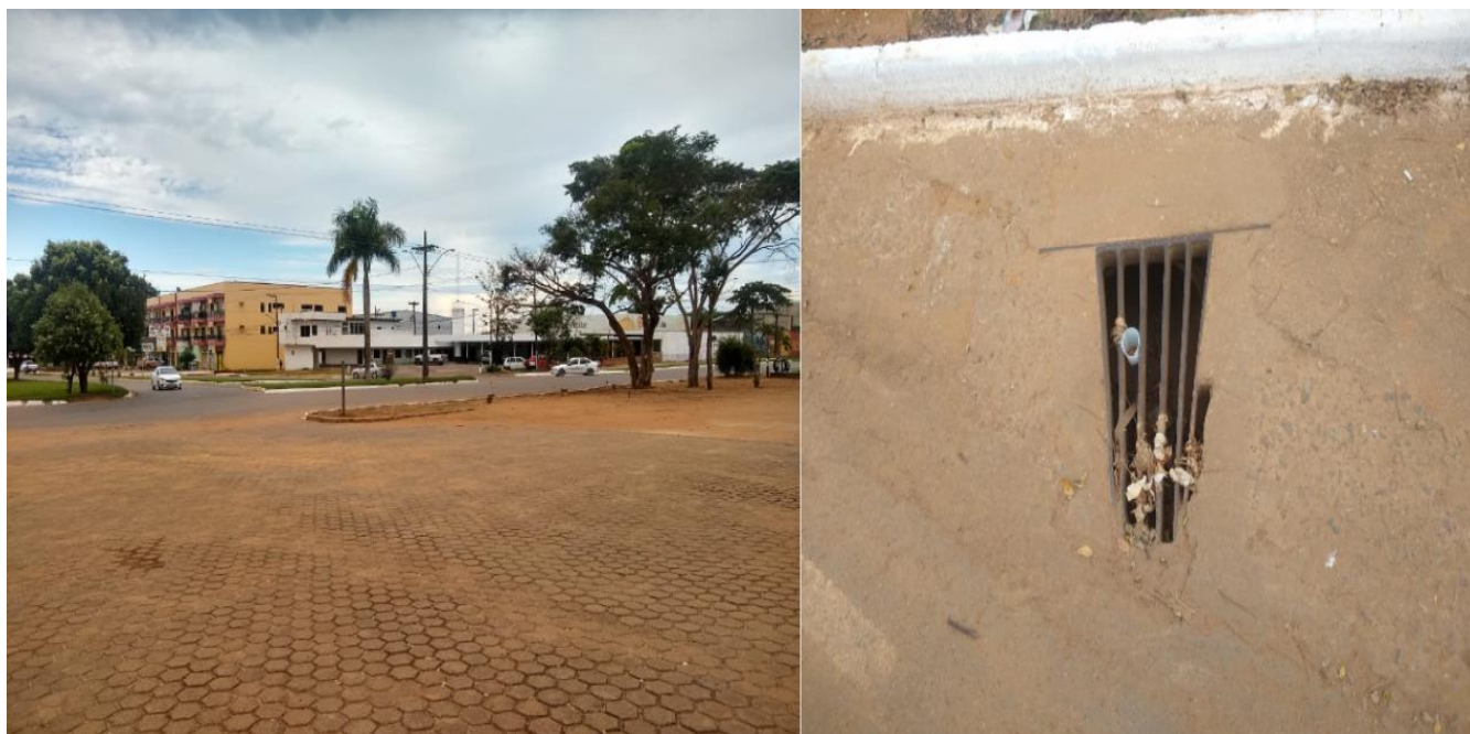
Figura 10– Trechos críticos de acúmulo de águas na Avenida Capitão Silvio com a boca de lobo existente
