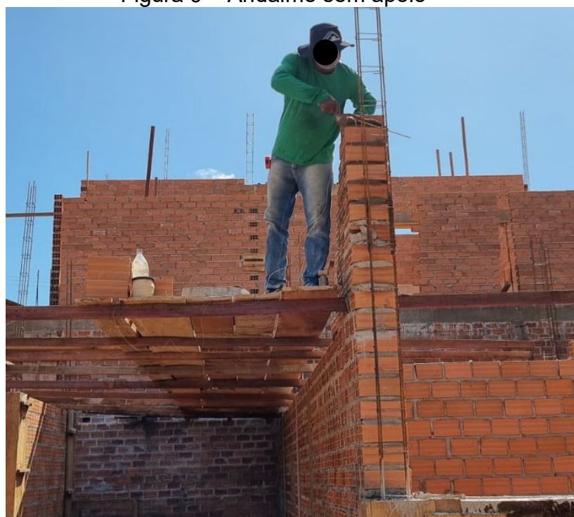
Figura 9 – Andaime sem apoio
