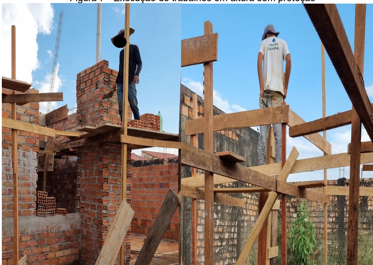
Figura 7 - Execução de trabalhos em altura sem proteção
