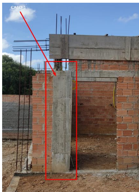
Figura 2: Erro de locação de pilar (Caso 1).
