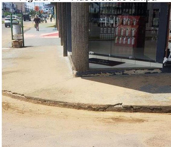
Figura 14 – Ausência de rampa
