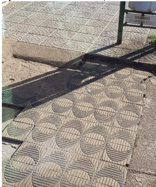
Figura 16 – Calçada mal conservada, com mobiliário e desnível
