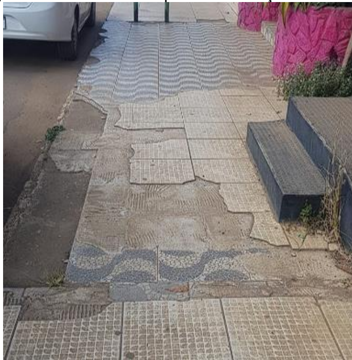
Figura 12 – Ausência de piso tátil e calçada danificada
