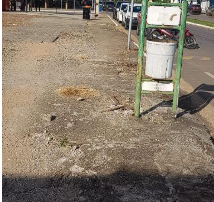
Figura 11 – Calçada com desnível e quebrada
