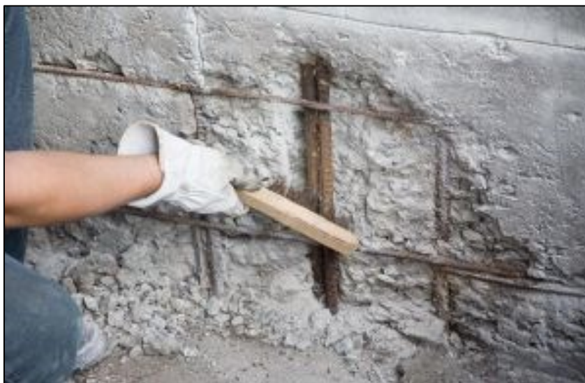
Figura 20 – Patologia por falha na execução
