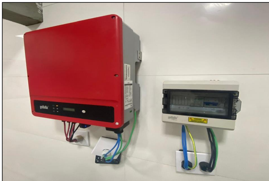
Figura 10 - Inversor solar On-grid com caixa protetora
