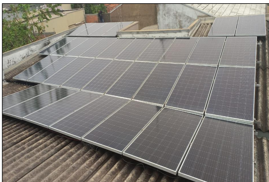
Figura 13 - Painéis instalados em cobertura residencial
